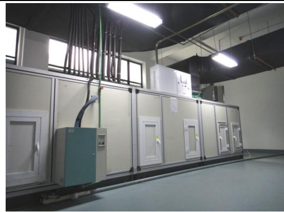
温湿度控制系统 Temperature and Humidity control system
